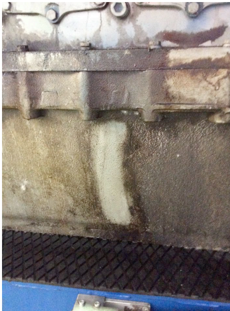
Ölwanne mit eingebrannten Schmutz und Öl sowie Dieselkraftstoff
